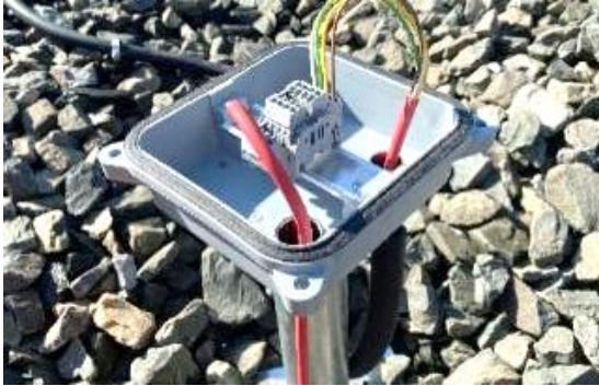
No hay electrónica en la caja de conexión en tierra
